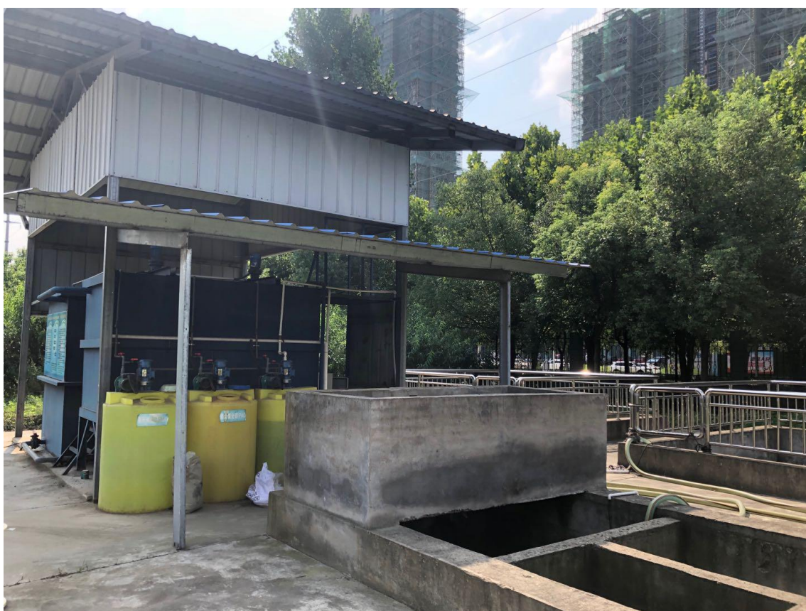
图 4-3 厂区自建污水处理站图
