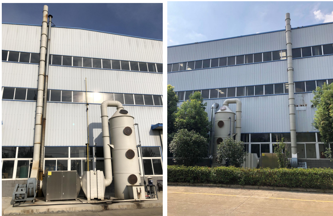
图 4-4 浸漆废气处理设施图
